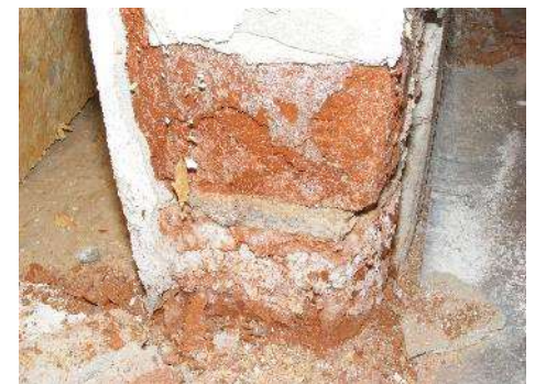
Bauteilfeuchte / bauwerksschädigende Salze
