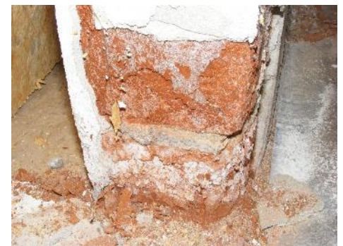
Bauteilfeuchte / bauwerksschädigende Salze
